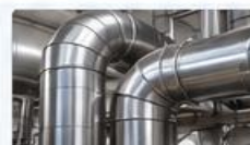
کانال‌های تهویه و سیستم‌های هوارسانی
