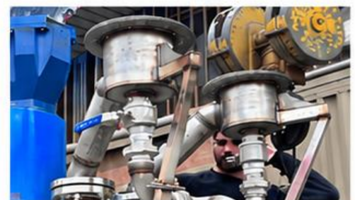
اتصالات و تجهیزات جانبی
